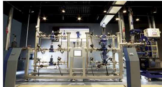
02 압력, 온도 컨트롤, 열교환기 파이롯트 장치 감압밸브, 컨트롤밸브, 열교환기
