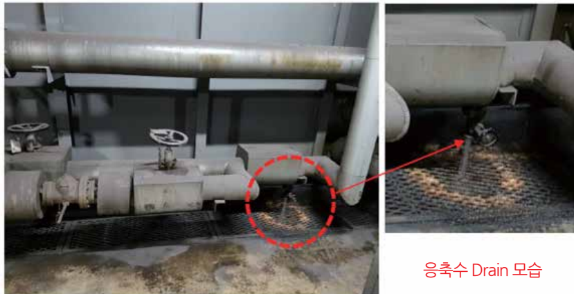
그림 7. Coolant Tank 스팀 코일 응축수 회수 계통 문제점
