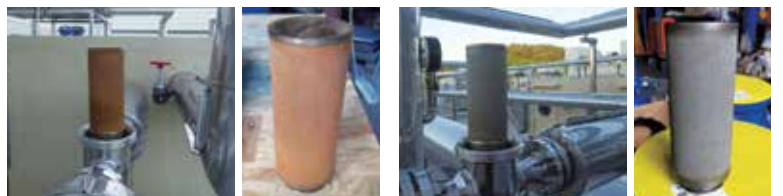
필터 세정 전 → 필터 세정 후
