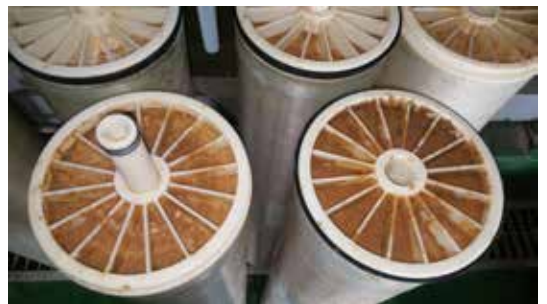
RO membrane Fouling 발생 사진
