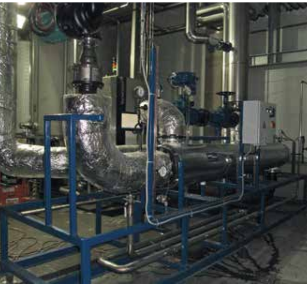
Die neue Turflow-Station erwärmt mit 5 bar ü Satttdampf das Heißwassernetz auf 120 °C.
