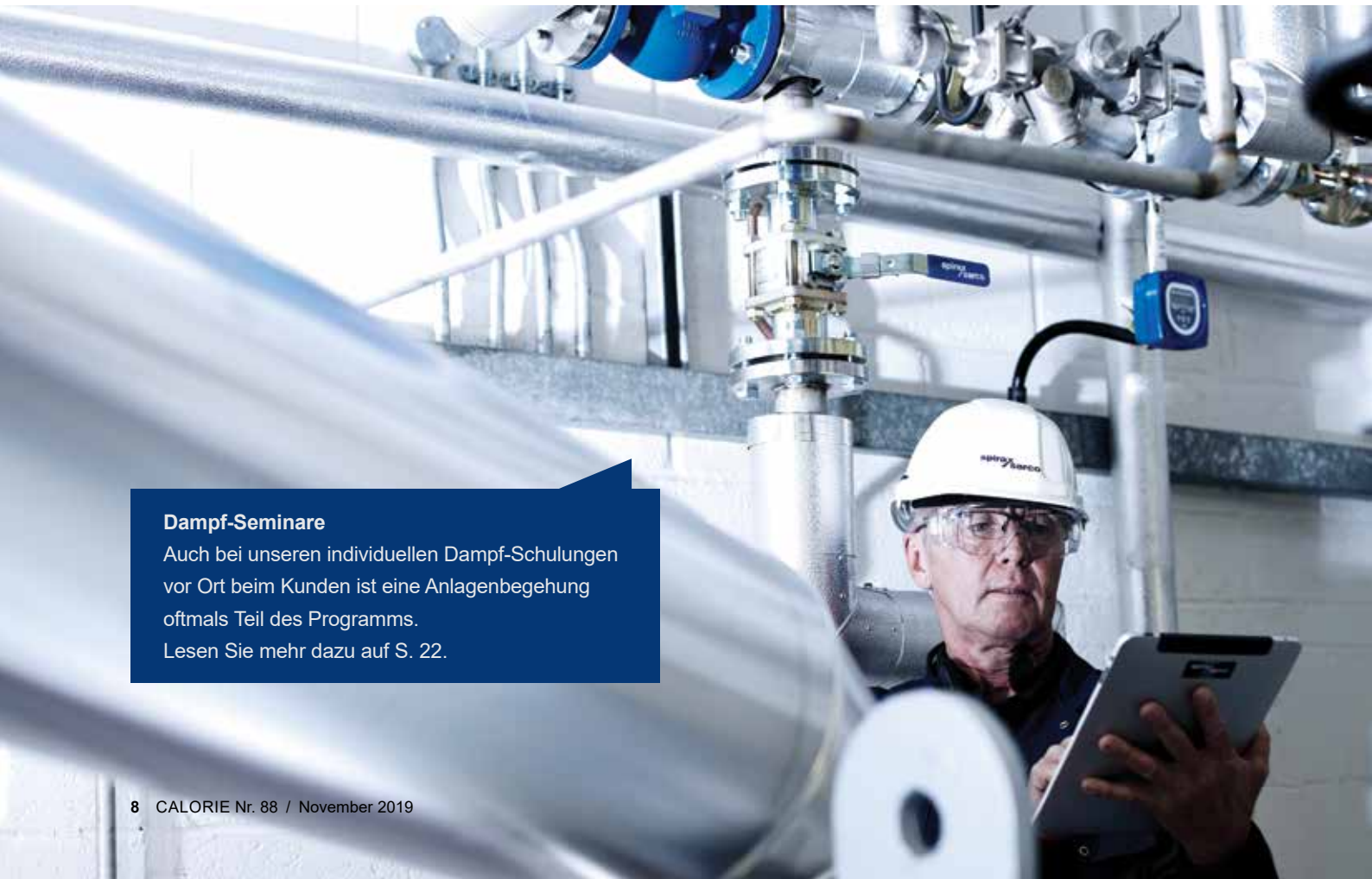
▼ Abbildung 7: Bei einem Dampfqualitäts-Audit erfolgt eine Analyse und Bewertung der Kundenanlage durch einen erfahrenen Fachingenieur von Spirax Sarco
