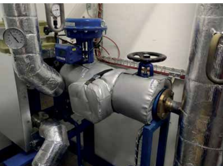
▲ Abbildung 2: Wärmedämmung einer Regelgruppe eines Wärmetauschers, bestehend aus Absperrventil, Schmutzfänger und Regelventil
