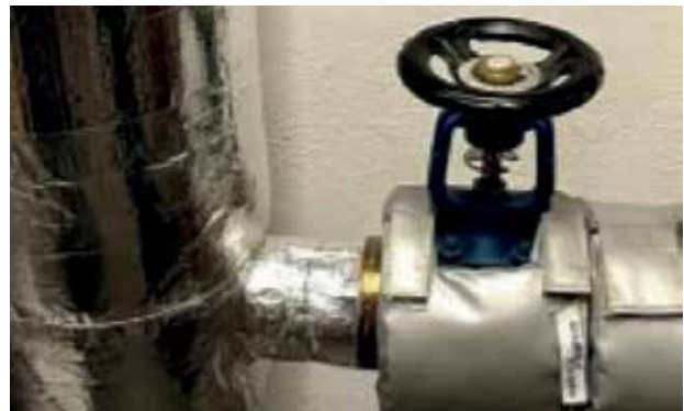
▲ Abbildung 4: Fehlende Gegenflansch-Isolierung
