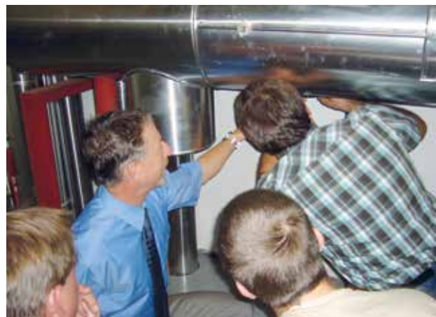
▲ Seminare beim Kunden vor Ort werden oftmals durch eine Anlagenbegehung abgerundet.
