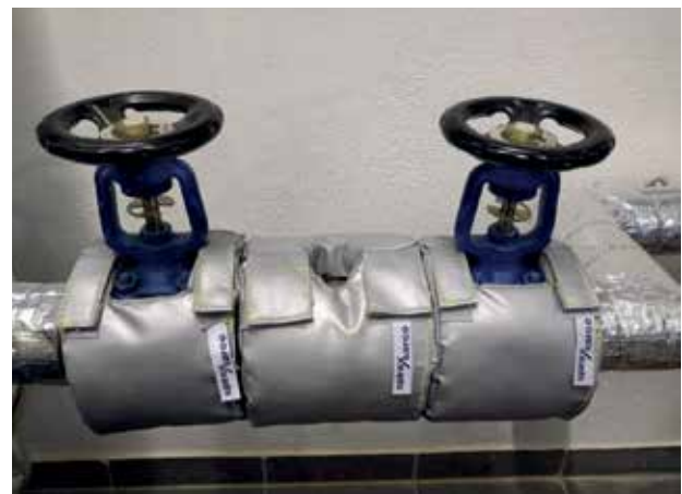
▲ Abbildung 1: Wärmedämmung einer Kondensatableitergruppe, bestehend aus Absperrventilen und einem thermodynamischen Kondensatableiter, bei dem eine Wärmeabfuhr nach oben gegeben sein muss.
