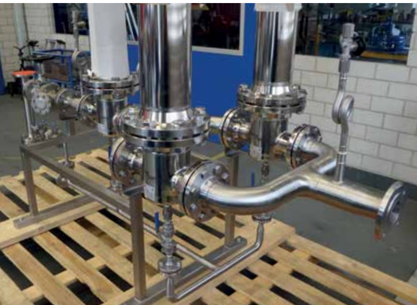
▲ Abbildung 3: Filterstation mit zwei Stufen und Druckreduzierung
