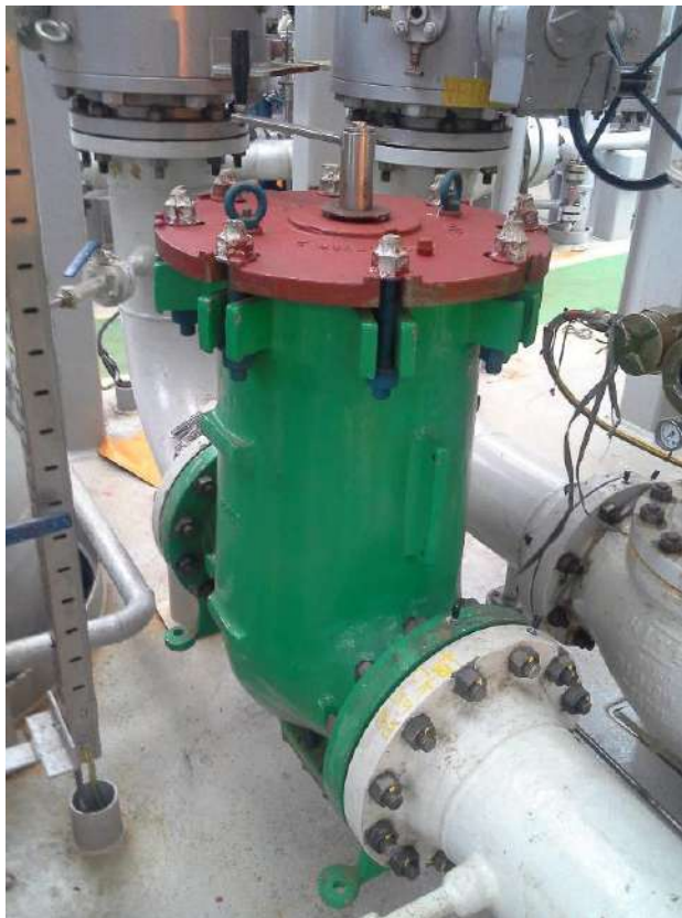
Figura 14 – Filtro suportado pela tubulação
