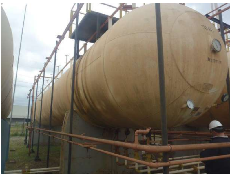
Figura 28 – Vaso de pressão de GLP (Fonte do autor)
