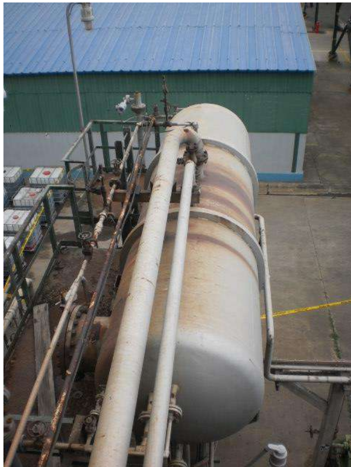
Figura 24 – Vaso de pressão em refinaria de petróleo (Fonte do autor)
