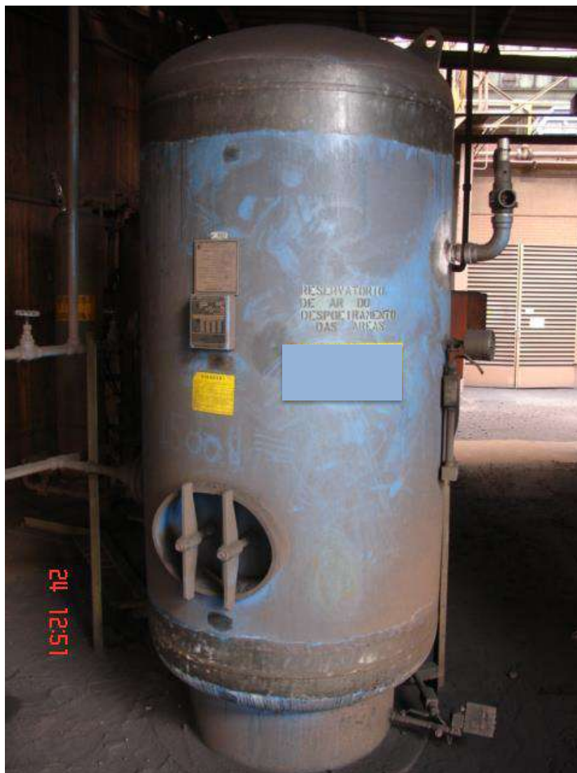
Figura 26 – Reservatório de ar comprimido (Fonte do autor)
