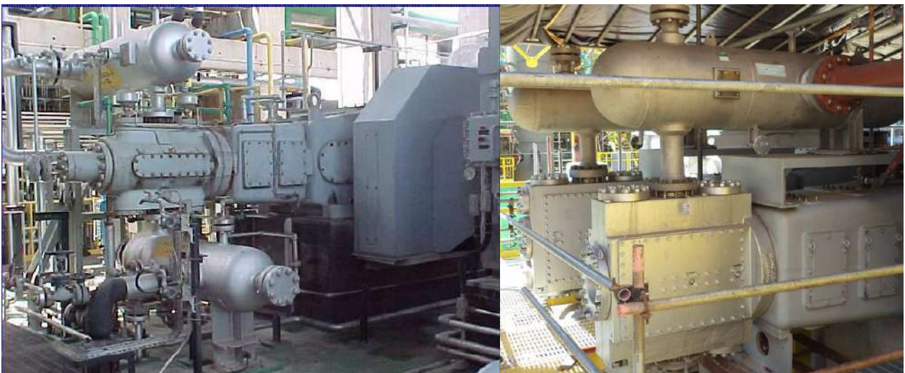
Figura 7 – Vasos de pressão localizados na sucção e na descarga de máquinas.
