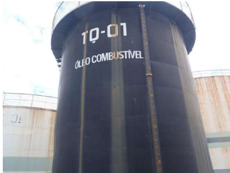
Figura 06 – Tanque de óleo combustível (Foto do autor)
