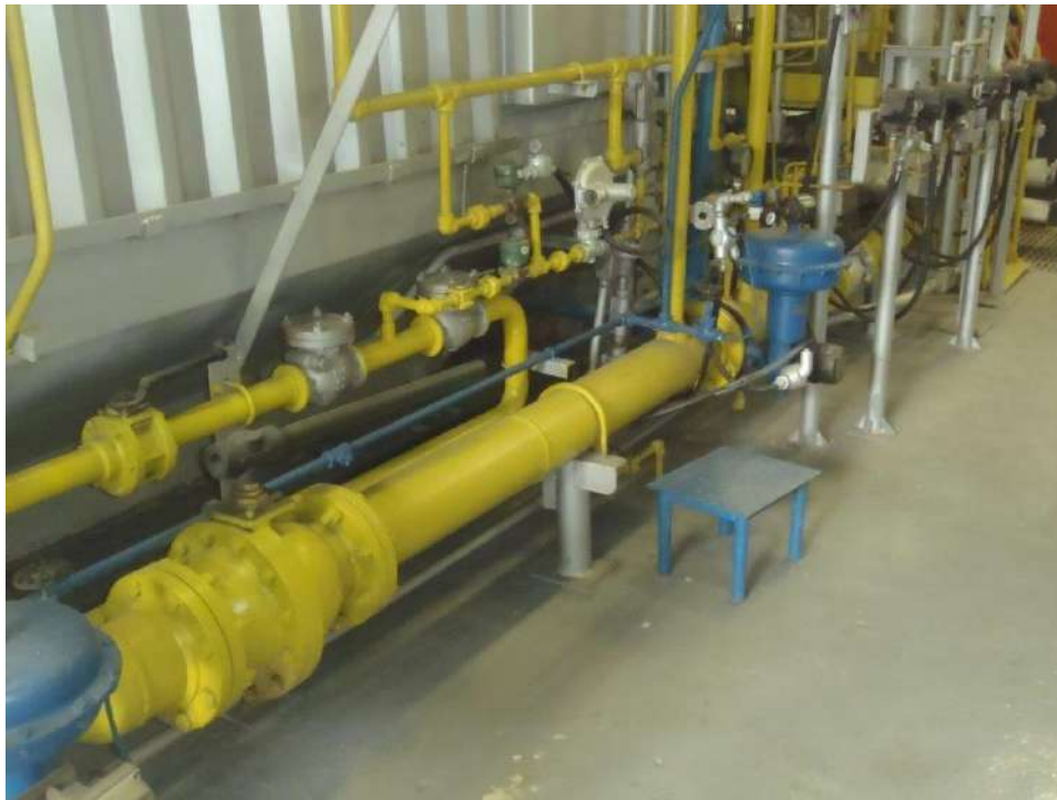
Figura 33 – Skid de gás natural ao lado de uma caldeira (Fonte do autor)
