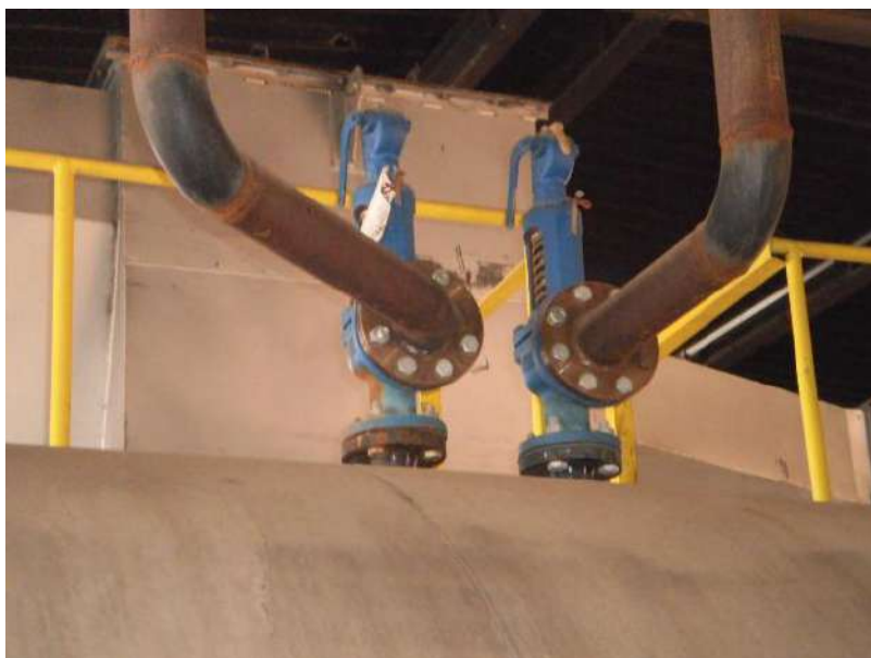
Figura 15 – Foto de duas válvulas de segurança instaladas em caldeira flamotubular (Fonte: autor)
