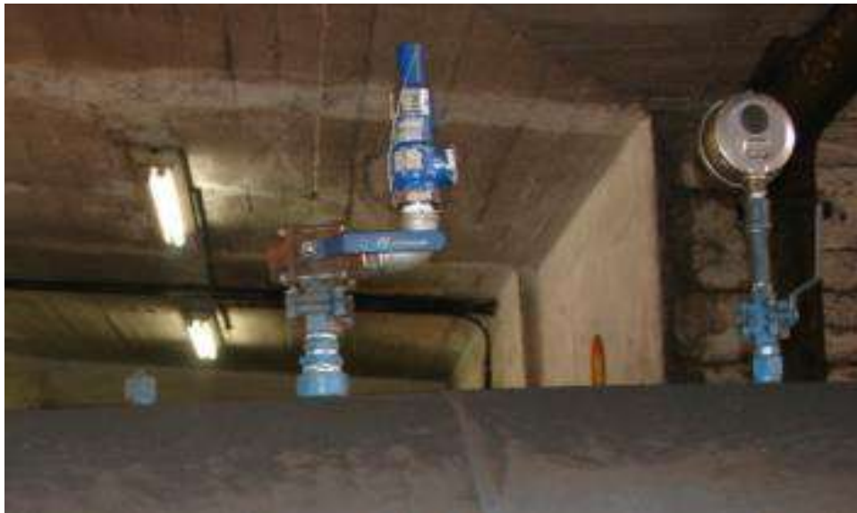
Figura 31 – Válvula esfera de 3 vias instalada entre o vaso de pressão e a válvula de segurança (Fonte: Autor)
