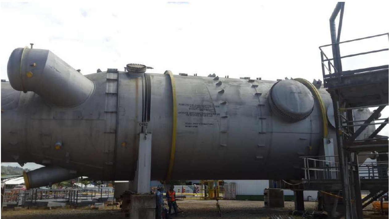
Figura 25 – Reator de processo petroquímico a ser instalado (Fonte do autor)
