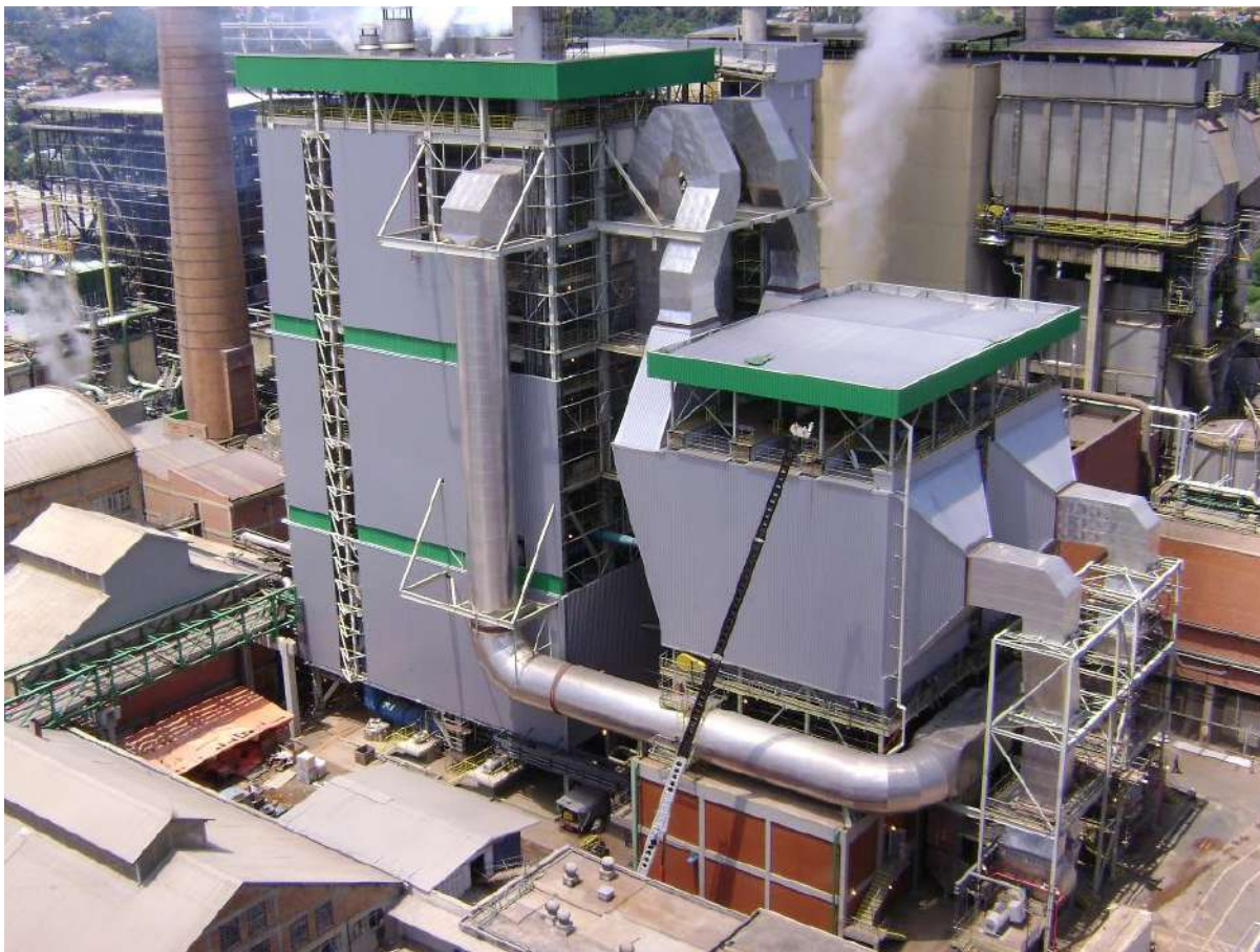
Figura 19 – Caldeira de recuperação de álcalis (Fonte: CBC)
