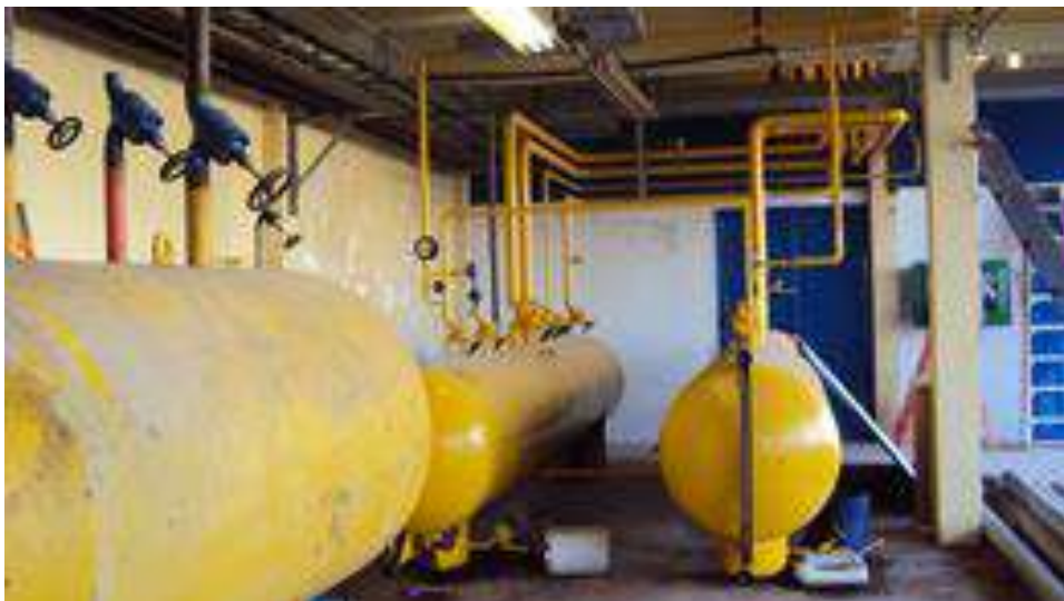
Figura 35 – Tubulações de amônia interligando vasos de pressão (Fonte do autor)
