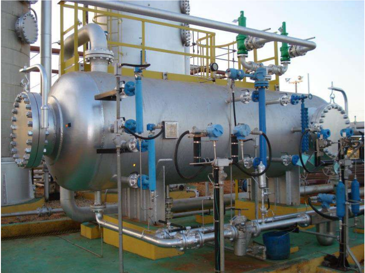
Figura 23 – Vaso separador (Fonte do autor)
