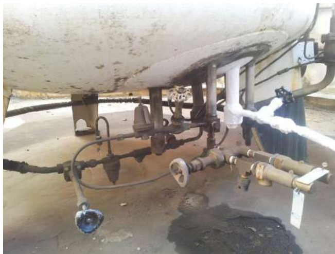
Figura 32 – Parte inferior de uma vaso de pressão de oxigênio líquido (Fonte: Autor)
