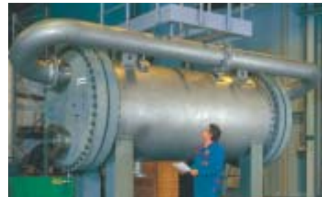
30 MW 페수 이코노마이저, 타입 14HH-968/2/2 에틸렌 옥사이드 공장
