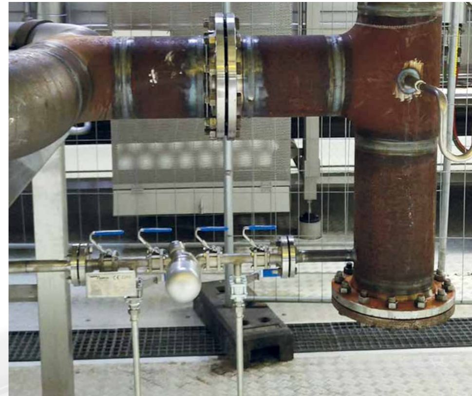
STS17.2-DBB zur Leitungsentwässerung
