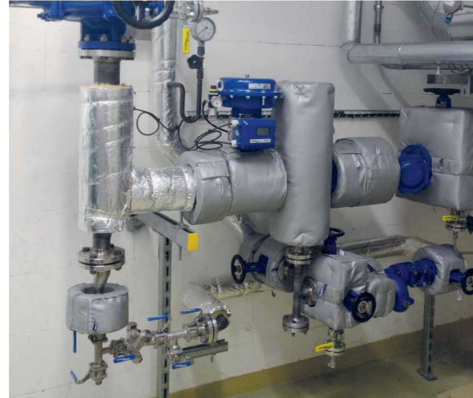
STS17.2-DBB in Druckminderstation in Kombination mit DBB3-Safebloc-Ventilen
