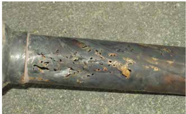
Bild 4: Beschädigungen von Dampfkondensatrohren können in relativ kurzer Zeit durch Sauerstoffkorrosion entstehen.
