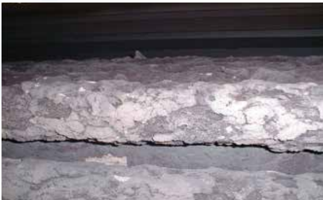
Bild 3: Ablagerungen aus Kalziumkarbonat auf den Dampfkesselrohren und auf der Oberfläche eines Großraumkessels
