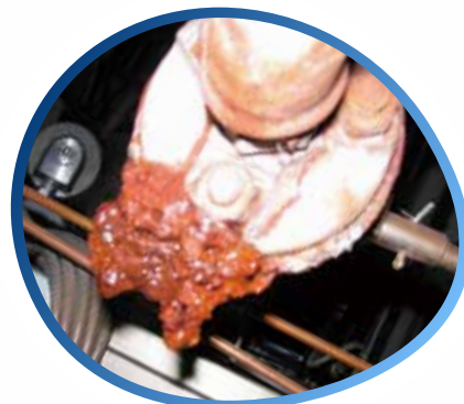
灭菌蒸汽进口管道法兰结垢
