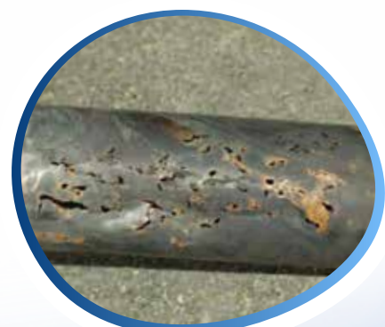
工业蒸汽管道腐蚀
